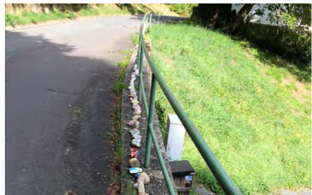
Bild 60: Mauer und Geländer an der Durchfahrtsstraße in Reifenberg, hier mit ‚bemalten Steinen‘ im Frühjahr 2020
